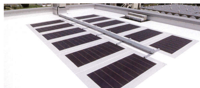
京都府 某大学浄水施設 (設置ワット数: 1.2kW)
