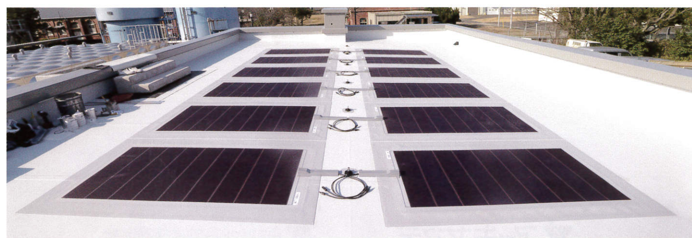
京都府 某大学浄水施設 (設置ワット数: 1.2kW)
